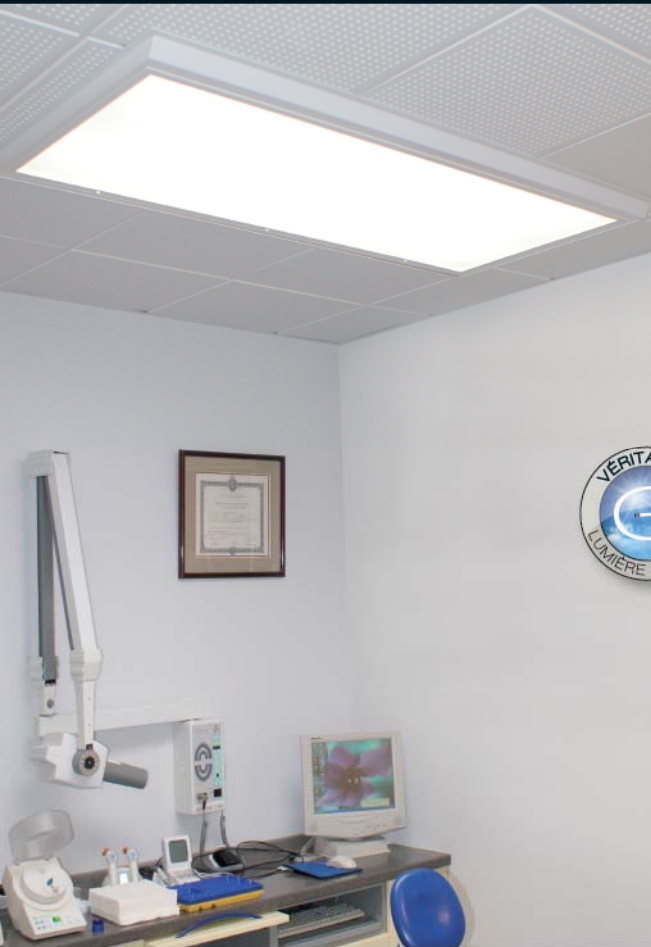
Plafonnier encastré dans le faux plafond
